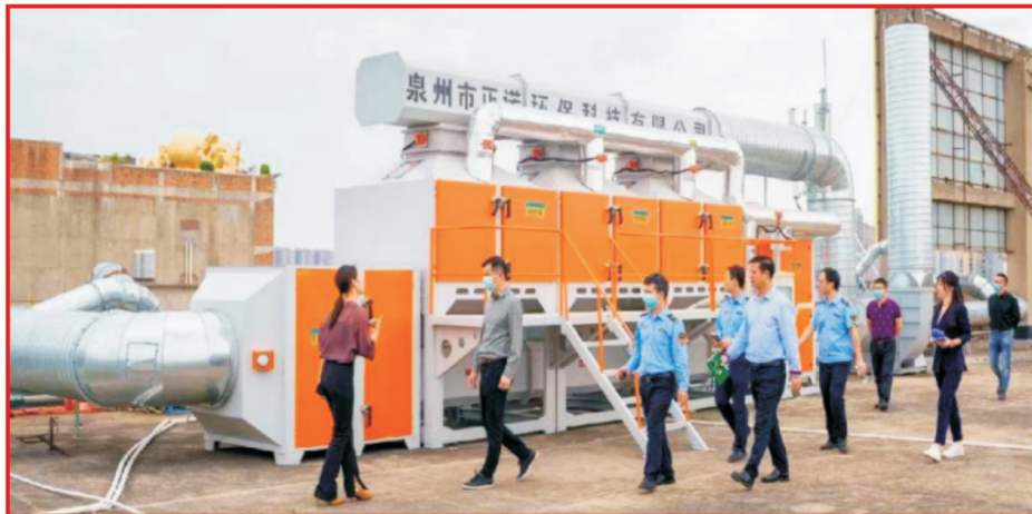
制鞋行业废气治理设备现场
