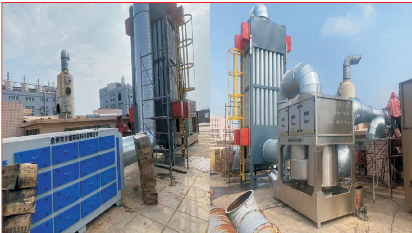
机械行业废气处理设备现场
