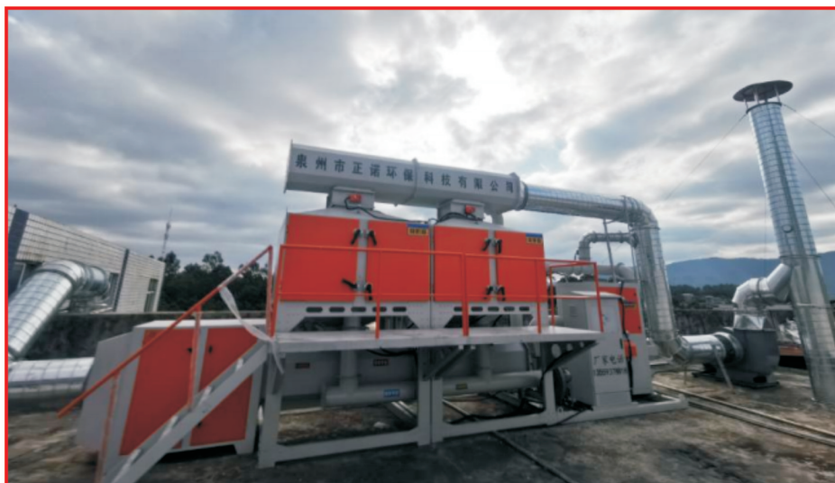
橡胶塑料制品行业废气治理设备现场
