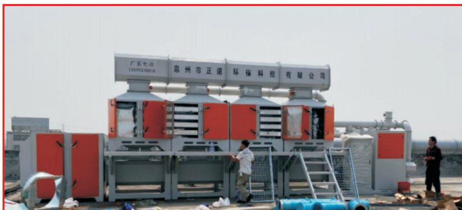
制鞋行业废气治理设备现场
